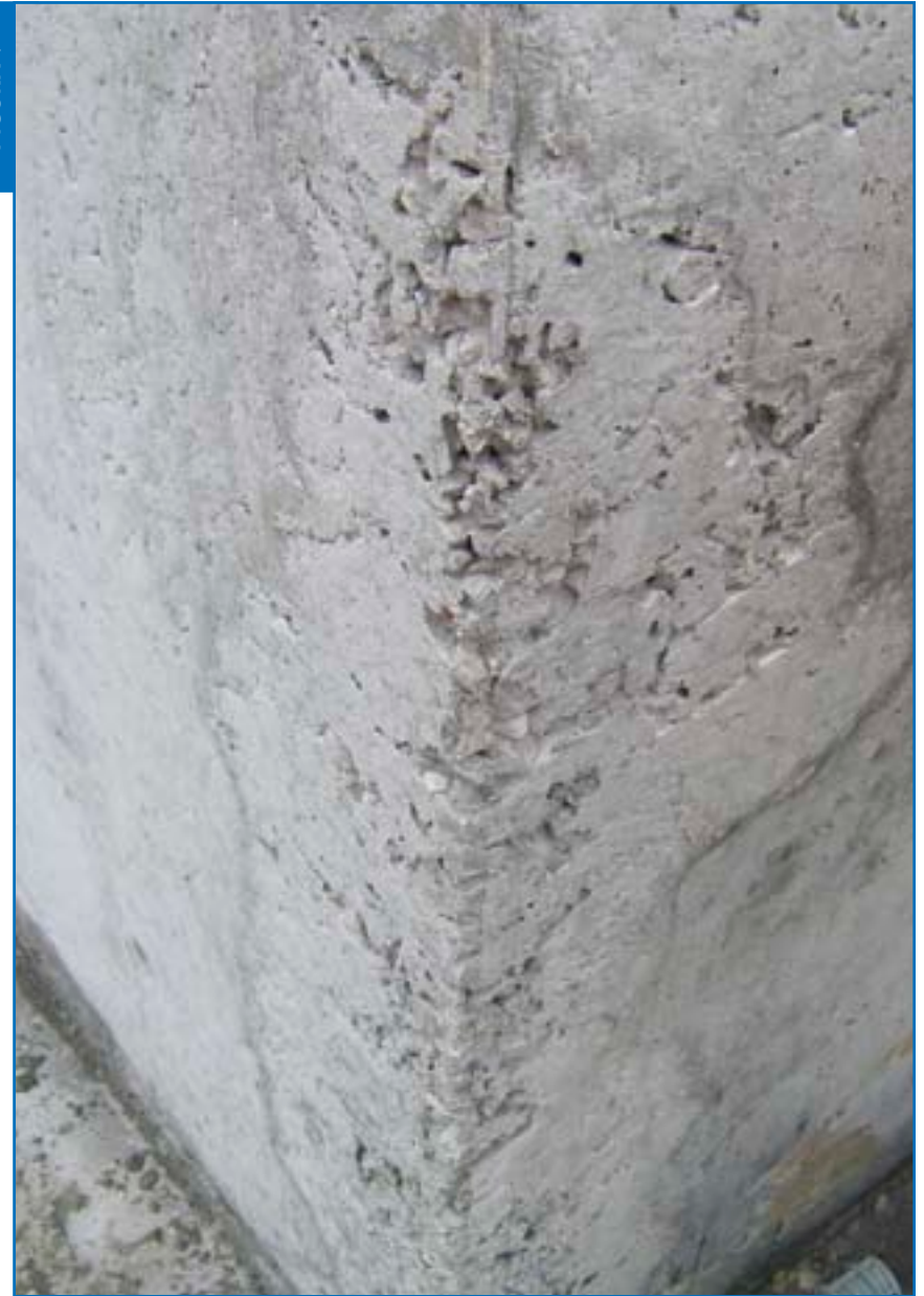
Esempio di "nido di ghiaia" formatosi per perdita di pasta di cemento tra due pannelli di una cassaforma.
