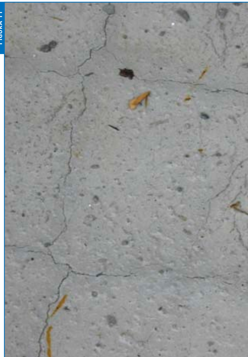
Tipico fenomeno di fessurazione per assestamento plastico su un solaio, accentuato dalle aggiunte d'acqua effettuate per facilitare la stesura della caldana.
